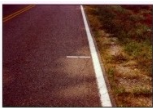
Слика 6.56. Ивичне пукотине
