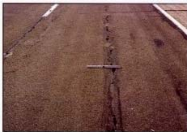
Слика 6.57. Подужне пукотине
