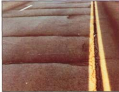
Слика 6.58. Рефлектоване пукотине при великом развоју оштећености
