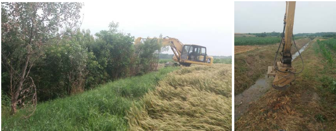
Слика 17 - Обраслост канала вегетацијом (лево) и несметани проток воде након уклањања вегетације (десно)
