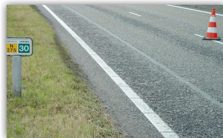
Slika 10: Stvaranje pukotina verovatno uzrokovano previše visokom poroznošću
