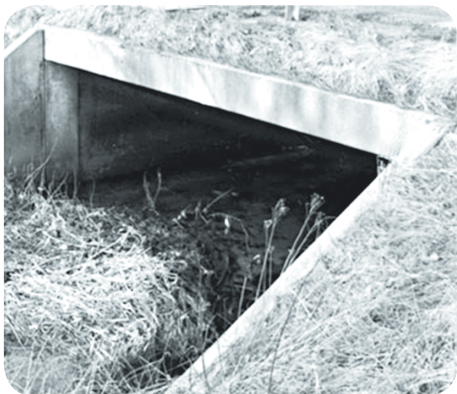
Сл. Блокиран водоток
