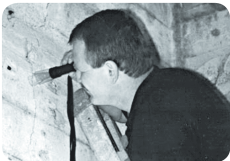
Сл.Мерење отвора прслинау бетону
