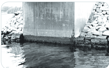
Сл. Разарање заштитног слоја опорца.
