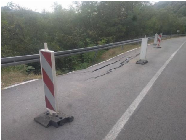
Слика 2. Изглед оштећења на државном путу
