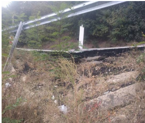
Слика 3. Оштећење банке и насипа
