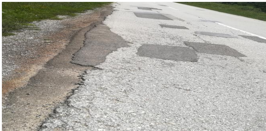
Слика 19. Пример оштећења на деоници
