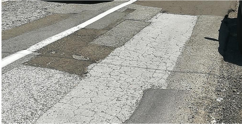
Слика 21. Пример оштећења на деоници
