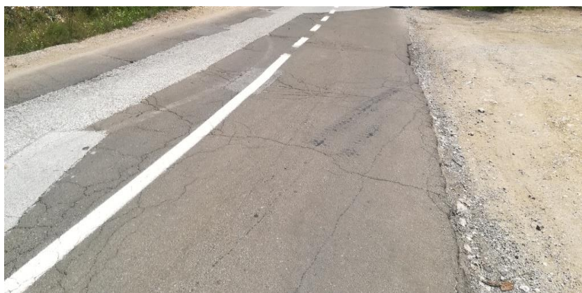
Слика 20. Пример оштећења на деоници
