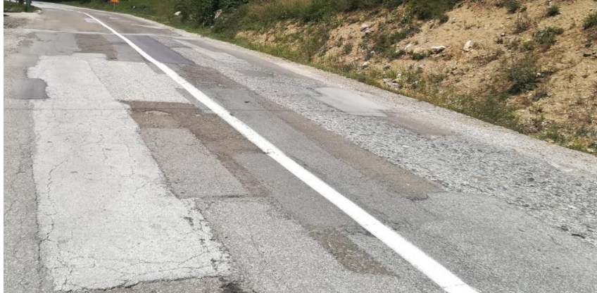
Слика 18. Пример оштећења на деоници
