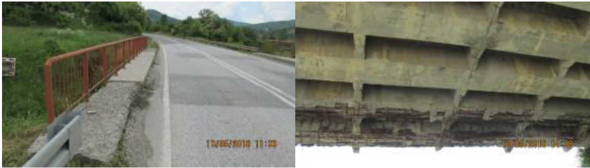
Слика 12. Типична оштећења на мостовима
