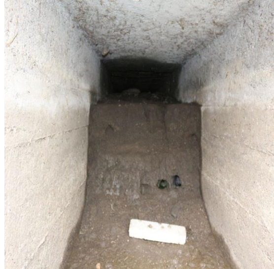
Слика 2-35 Пропуст запуњен материјалом, на км 31 +151
