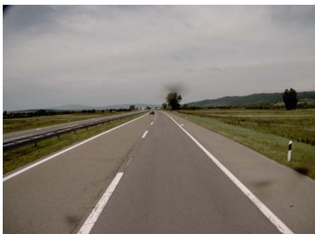
Слика бр. 36 Оштећења коловоза
