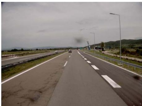
Слика бр. 38 Оштећења коловоза
