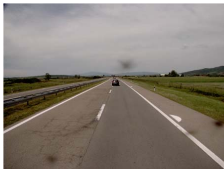
Слика бр. 37 Оштећења коловоза
