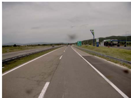
Слика бр. 39 Оштећења коловоза
