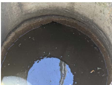
Слика бр. 18 - Задржавање воде у шахту
