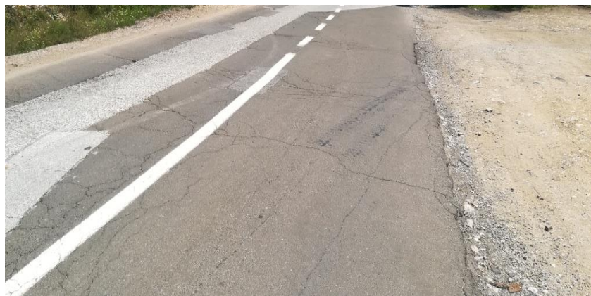
Слика 20. Пример оштећења на деоници
