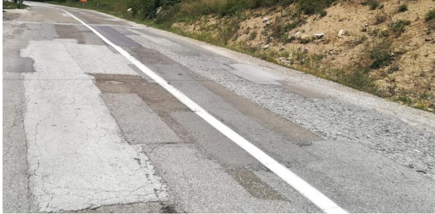
Слика 18. Пример оштећења на деоници
