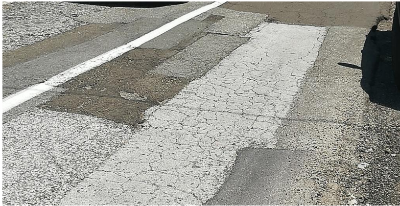
Слика 21. Пример оштећења на деоници
