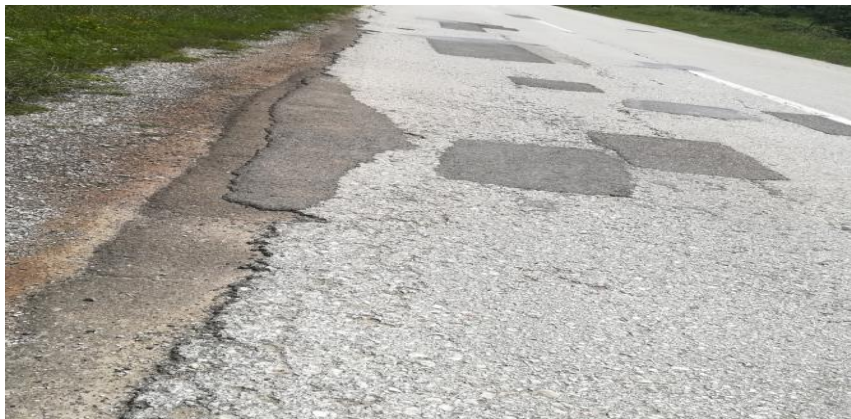
Слика 19. Пример оштећења на деоници
