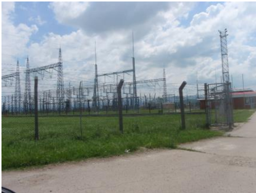
Слика 6. Трафо станица-далековод "Лесковац 2"
