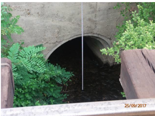
Слика 7 засведен пропуст на km 72+725
