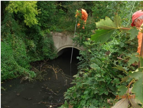
Слика 5 зацевљење \phi 2000mm на km\ 66+925
