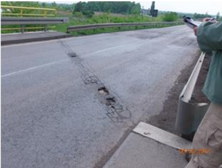
Слика 17. Пукотина у асфалту на крају конструкције
