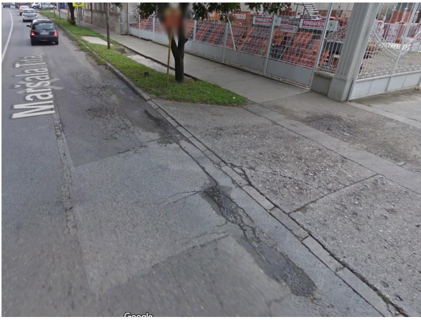
Слика 15. Пример оштећења на деоници
