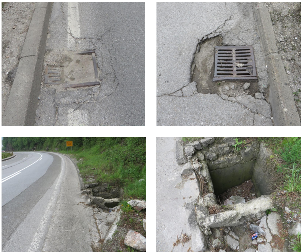
Слика 11. Оштећење елемената за одводњавање
