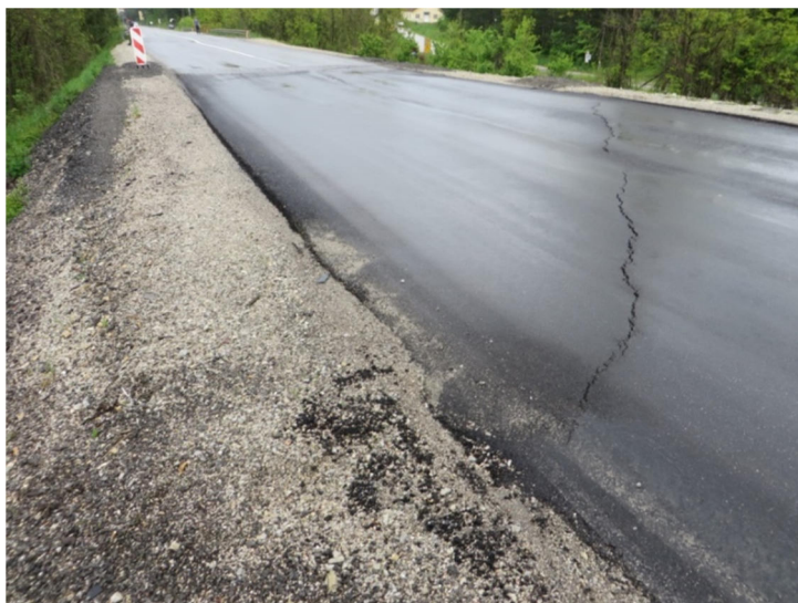
Слика 10. Деформација трупа пута
